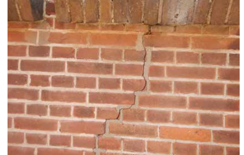
Scheuren in de muur
