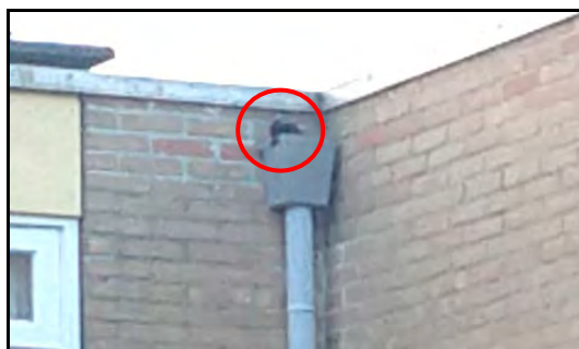
Afbeelding 4: Opening in gevel bij hemelwaterafvoer
